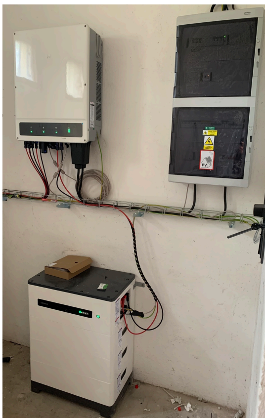
Obrázek 14 Sestava pro solární aplikaci, střídač a bateriové úložiště 9,9kWh
