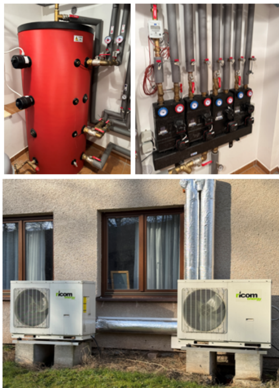
Obrázek 11 Dvě tepelná čerpadla vzduch-voda v KD
